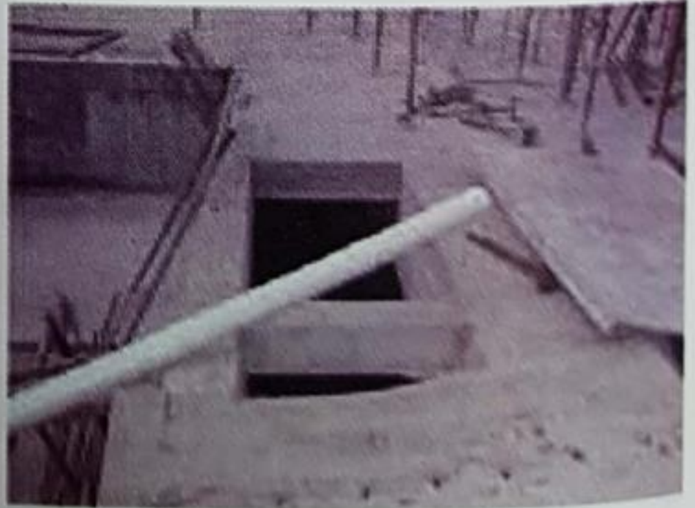
Bukaan yang tidak ditanda / dihadang
